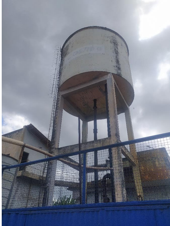
Figura 31 - Detalhe do Reservatório REL ETA. Fonte: Própria (2021)
