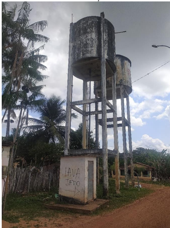
Figura 34 - Detalhe do Centro de Reservação Pacas-01. Fonte: Própria (2021)
