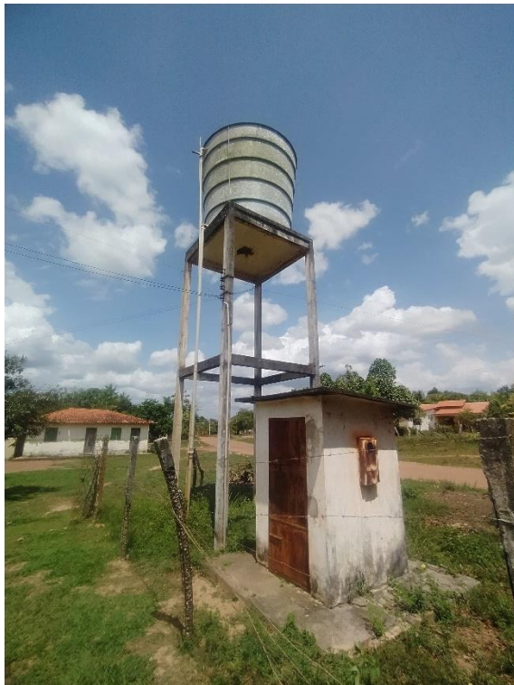
Figura 40 - Detalhe do Reservatório REL Ribeirão do Meio. Fonte: Própria (2021)
