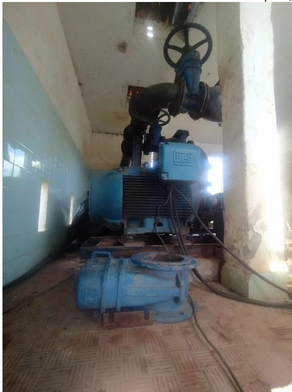
Figura 24 - Visão Interna da EEAB Pericumã. Fonte: Própria (2021)
