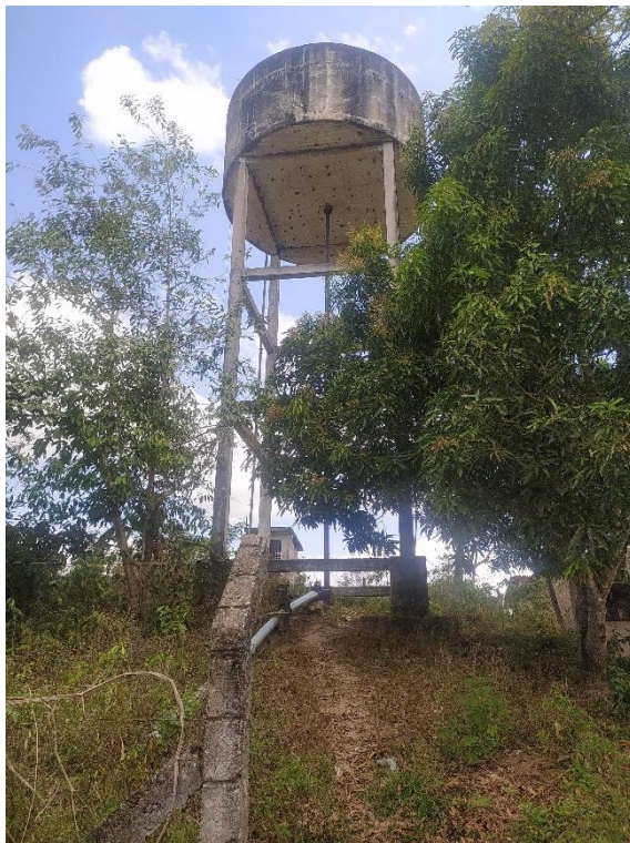
Figura 39 - Detalhe do Reservatório REL Maranhão Novo. Fonte: Própria (2021)
