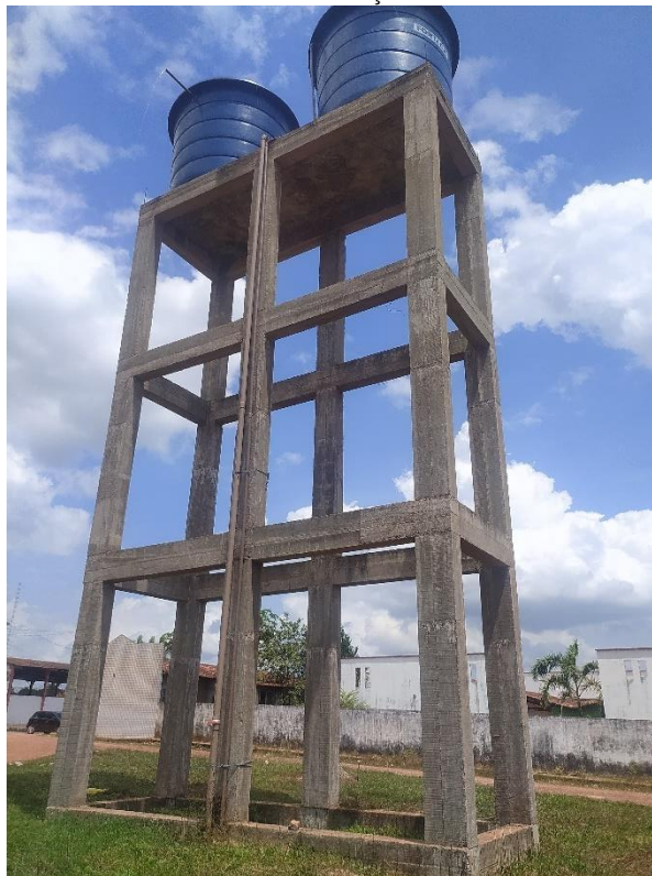
Figura 35 - Detalhe do Centro de Reservação Pacas-02. Fonte: Própria (2021)
