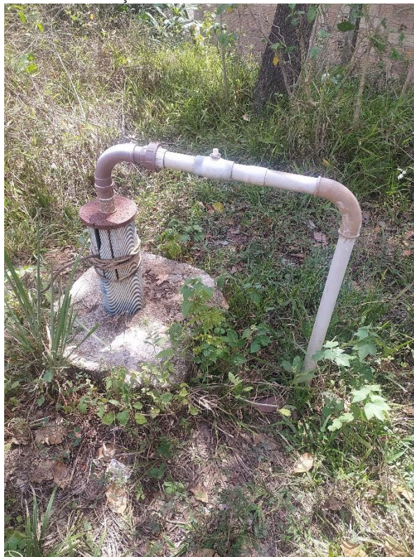
Figura 22 - Detalhe do Poço Povoado Maranhão Novo. Fonte: Própria (2021)
